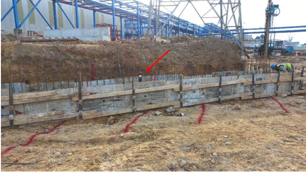
Şekil 3.40. Tie-back hattının arkasına yerleştirilmiş inklinometre – 2 (Öçal kişisel arşiv, 2022)
