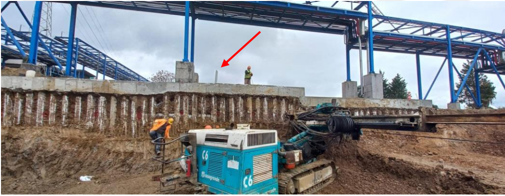
Şekil 3.39. Tie-back hattının arkasına yerleştirilmiş inklinometre – 1 (Öçal kişisel arşiv, 2022)
